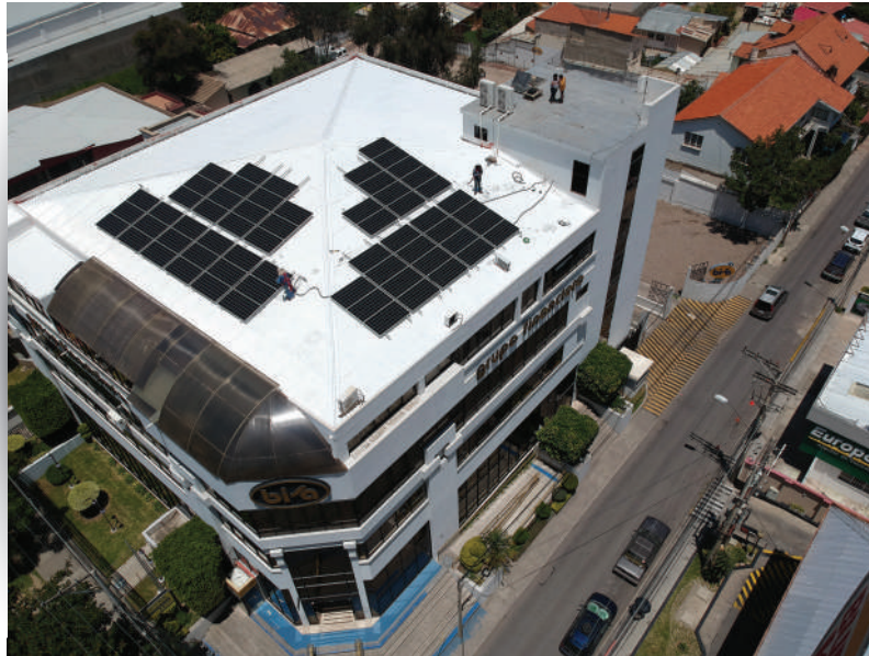
Paneles solares Edificio Principal Cochabamba
