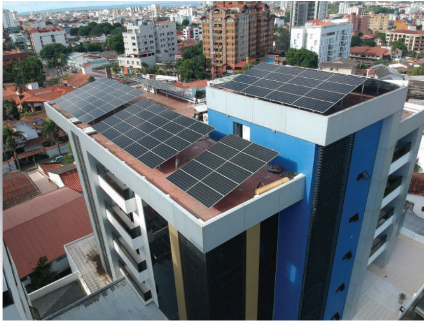
Paneles solares Edificio Principal Santa Cruz
