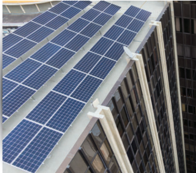
Paneles solares Edificio Nacional
