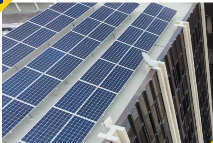
Paneles solares Edificio Nacional Banco BISA
